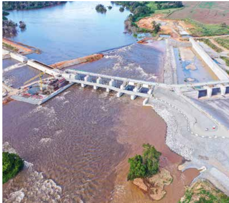
▼ A fines de 2022, las obras de la presa de Nachtigal (Camerún) llevaban un avance del 80 %
